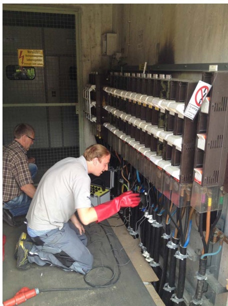
Abb. 3: Installation der Stromzangen an Unterverteilungen
