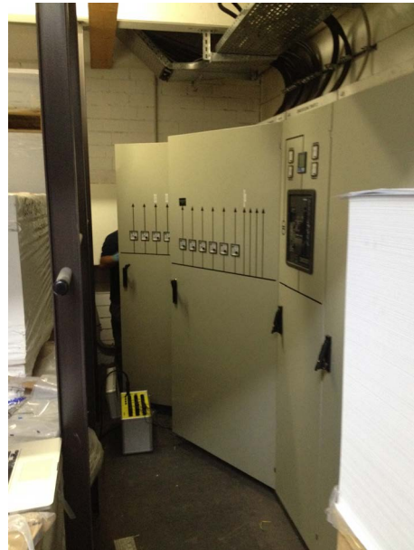
Abb. 2: Messkoffer vor Sicherungskasten
